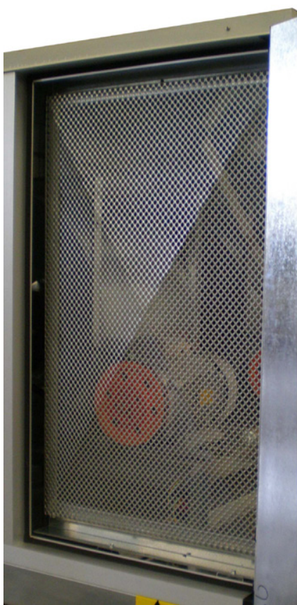
Rete di protezione / Protection grid
